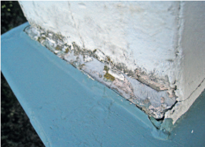
Undichtigkeiten im Fassadenbereich durch überalterte Kittfuge
