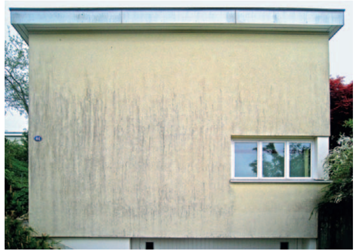
Typischer Algenbefall an Westfassade mit Kunststoffputz auf Polystyrol-Aussendämmung
