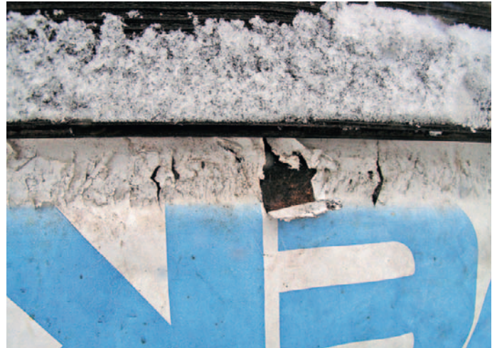
Durch eine 20 mm schmale Durchlüftungsöffnung im Fassadenbereich durch UV-Strahlung (tiefstehende Nachmittagssonne) innert 7–8 Jahren zerstörte Winddichtungsfolie
