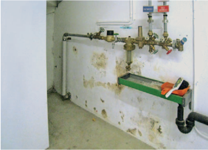
Weit verbreitetes Schadensbild im Kellerbereich durch feuchtigkeitsbedingte Salzausblühungen bei Zementputzen
