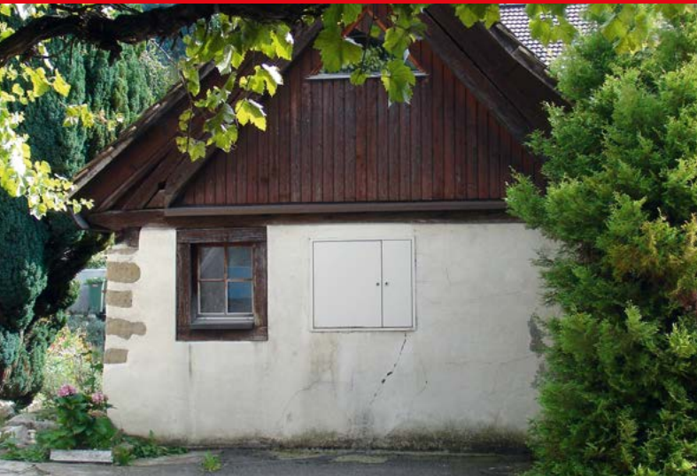
1 Typisches Rissbild Verputz
