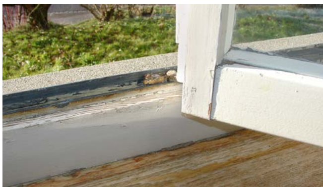
4 Feuchteschaden undichtes Fenster
