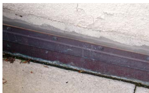
8 Wandanschluss Dachterasse mit erstem Feuchtigkeitsschaden
