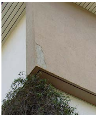
3 Abplatzung verputzte Aussenwärmedämmung
