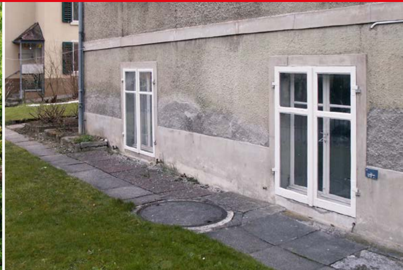
2 Typisches Schadensbild Fassadensockel
