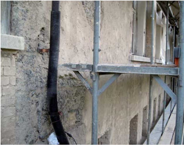
Rückführung. Nach dem Ablösen des später hinzugekommenen hydraulischen Deckputzes wird der noch vorhandene ursprüngliche Grundputz zur Weiterverarbeitung vorbereitet.
