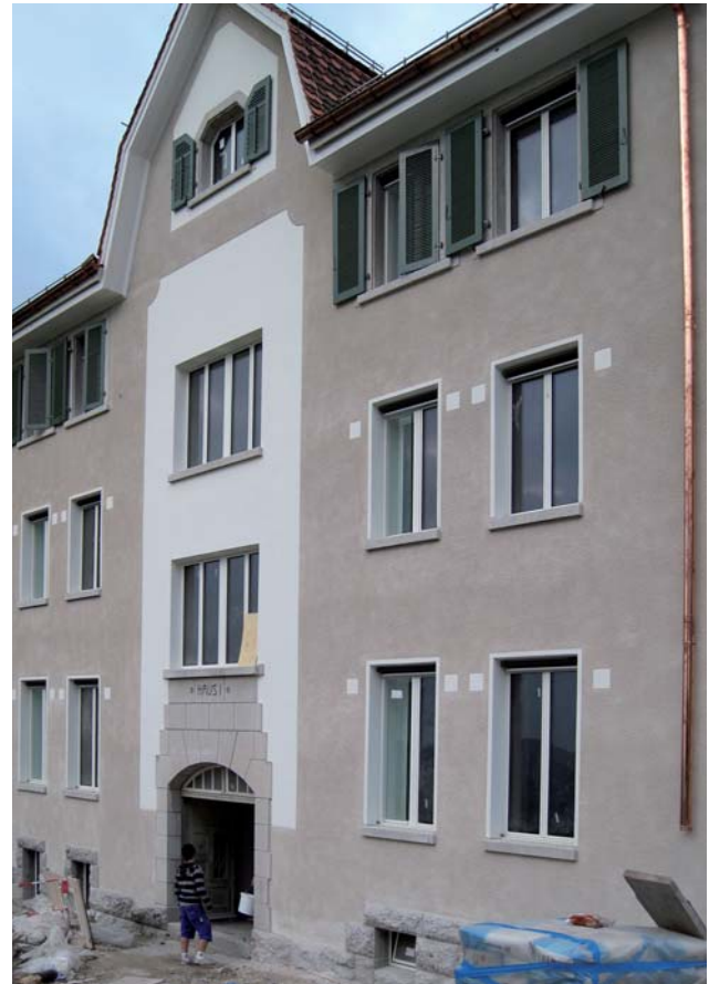
Schlusszustand. Die Farbgebung des Kalkputzes erfolgte ausschliesslich durch natürliche Zuschlagsstoffe wie Sande und Steinmehle.
